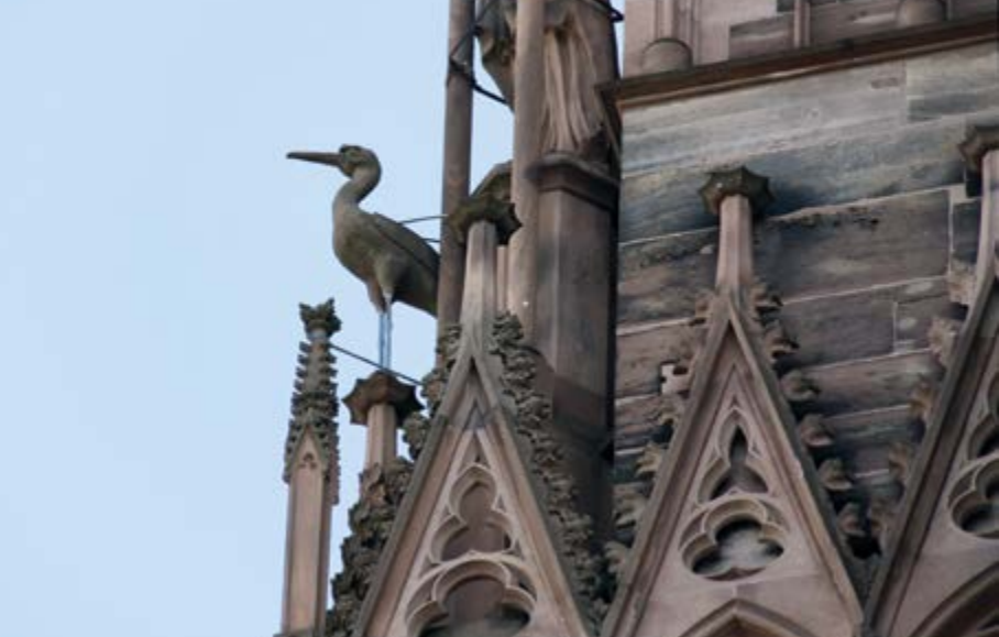
Eisenverstreibungen an der Westfassade
